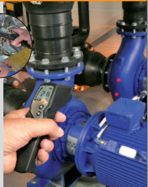
Kontrolle der Temperatur an einem Kompressor
