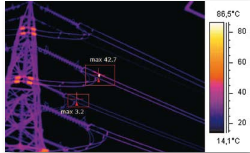
Aufnahme mit einer geometrischen Auflösung von 320x240 Pixel und einer thermischen Empfindlichkeit von 50 mK. Beachten Sie, wie aufgrund der höheren Pixelanzahl an der Problemstelle ein genauere Temperaturmesswert erzielt wird.
