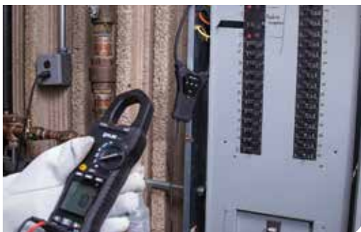
FLIR TA74 im Einsatz an einer FLIR CM83 Strommesszange
